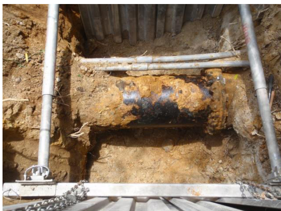
老朽管の外面
