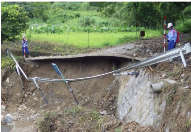
被災状況調査（道路調査班）
