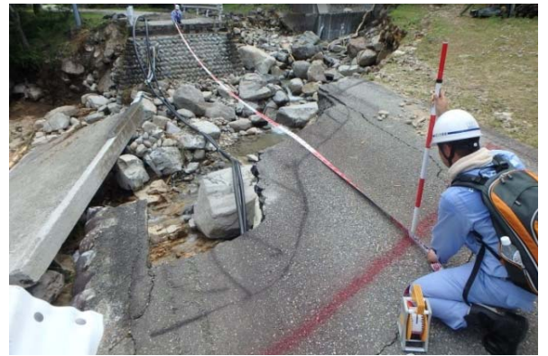
道路施設の被災状況調査
