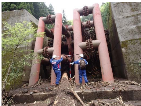
砂防施設の被害状況の調査
