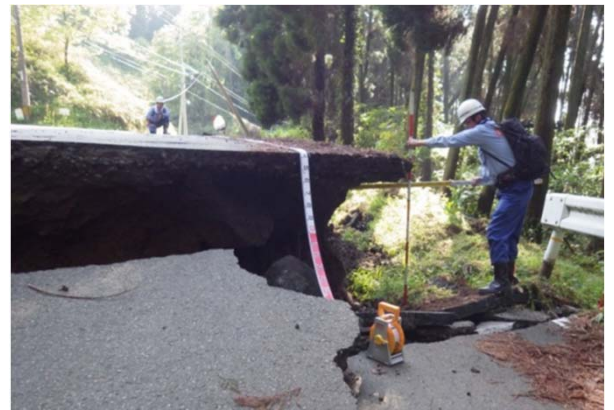
被災状況調査（道路調査班）
