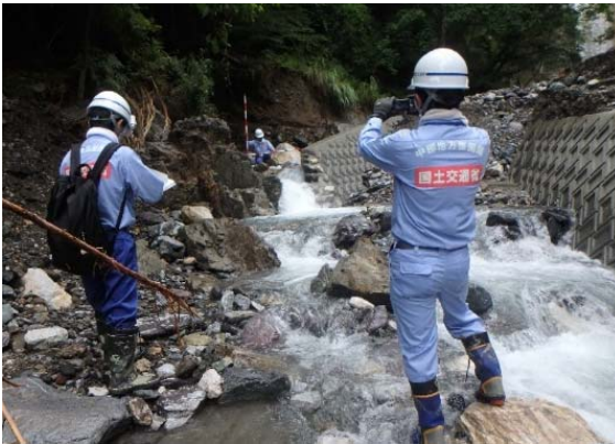
砂防施設の被災状況調査
