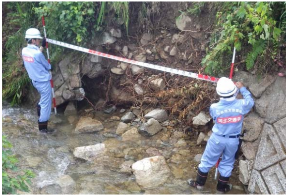
河川施設の被災状況調査
