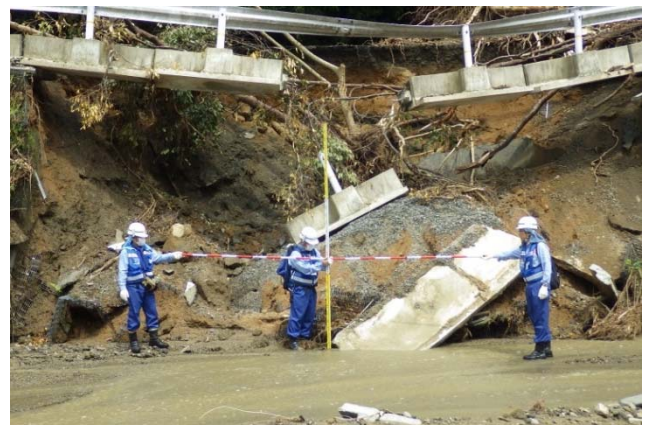
被災状況調査（河川調査班）
