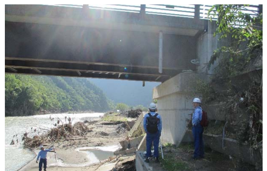
橋梁の被災状況の確認
