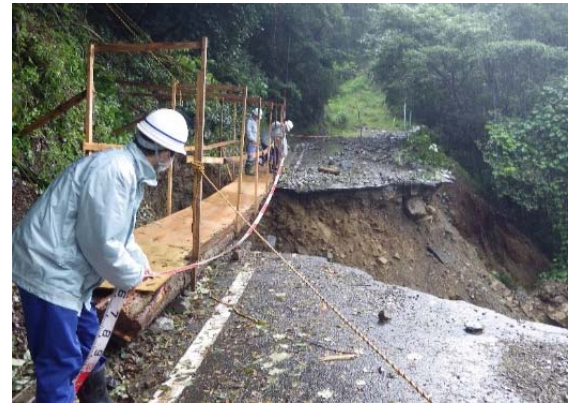
道路崩壊箇所の被災状況調査
