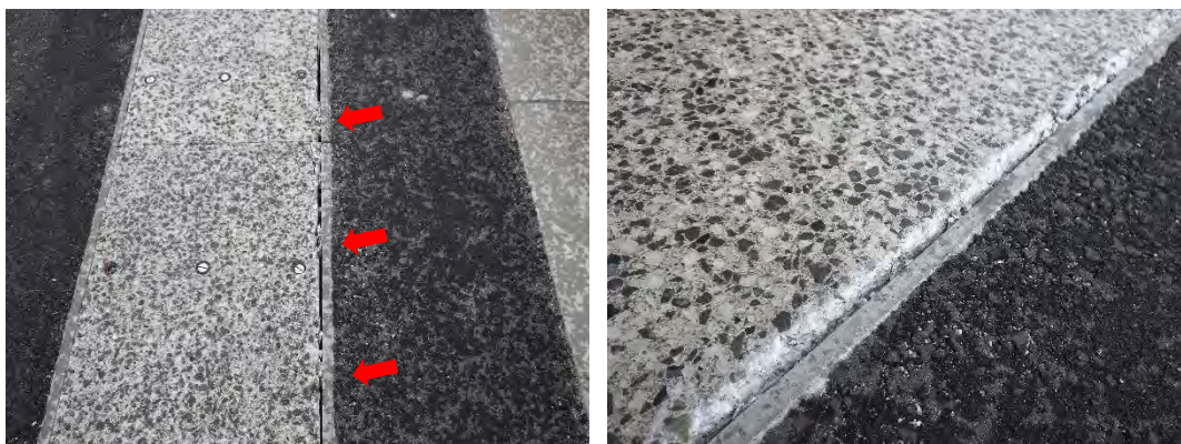
図 72 蓋の破損状況
