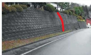
擁壁下端のハラミ出し
