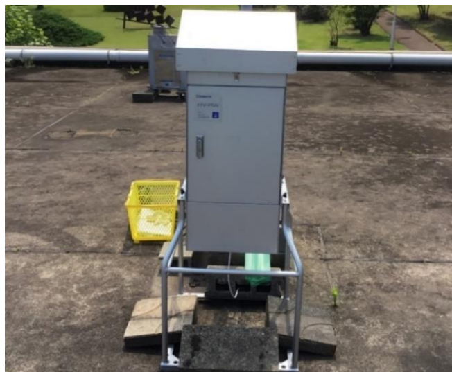
<ローボリューム・エアアンプラー（市役所公害防止センター）>
