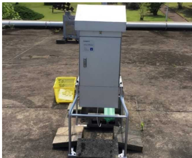
<ローボリュウム・エアアンプラー（市役所公害防止センター）>
