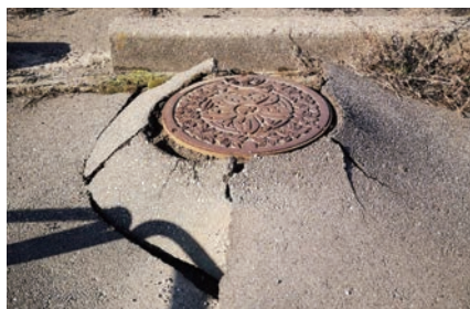
▲地震でマンホール付近が崩壊
