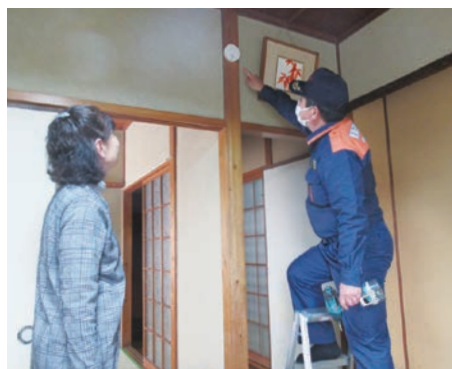
住宅防火診断
