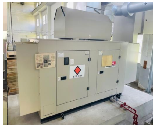
自家発電設備
