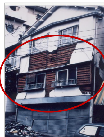
ロ：外壁が剥落し、著しく下地が露出している例（25 点）
