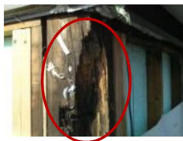
イ：局部的に柱で破損がみられる例
