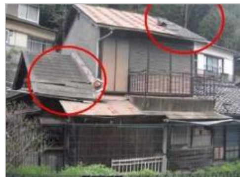
イ：アスファルト屋根等の一部にズレがあり、雨漏りのある例（15 点）
