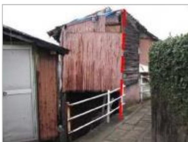
イ：一部の柱が傾斜している例
