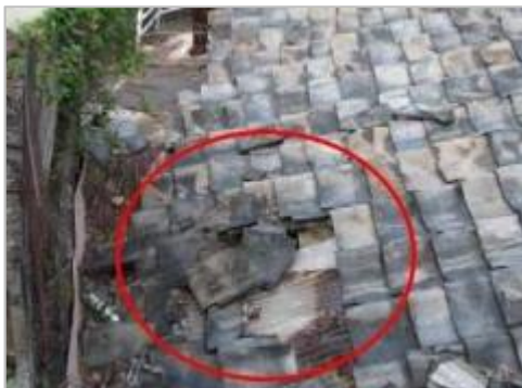
イ：瓦の一部に剥離とズレがあり、雨漏りのある例（15 点）
