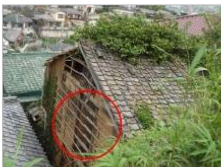
ロ：外壁が剥落し、著しく下地が露出し、壁体を貫通する穴を生じている例（25 点）
