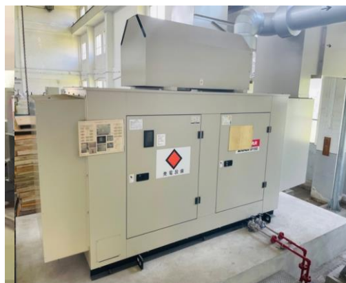
自家発電設備
