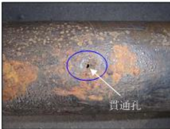
管が腐食し穴が開いた老朽管
