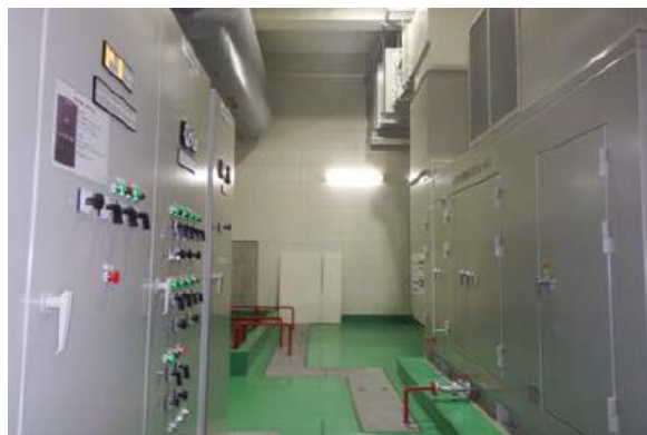
東海ポンプ場 電気計装設備の写真
