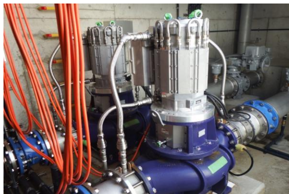
東海ポンプ場 マイクロ水力発電の写真
