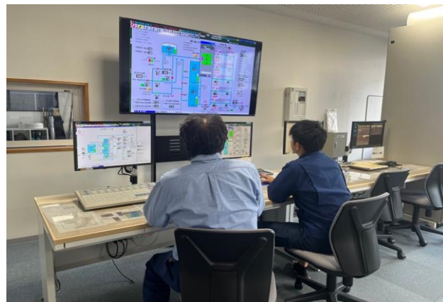
東海ポンプ場管理棟運転管理室の写真
